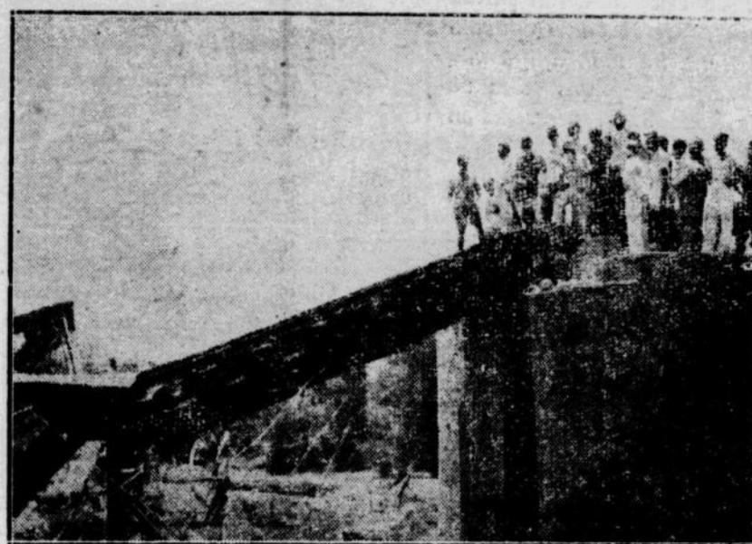
DJEMBATAN KALIOSO RUSAK
